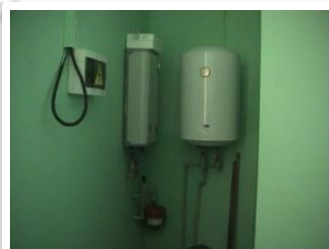
Эл.котел на 6 кВт
